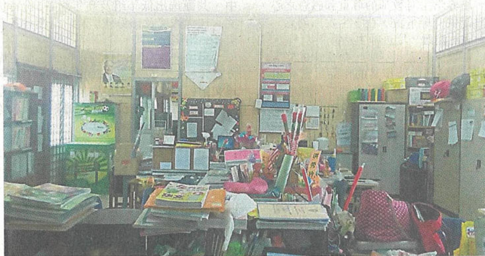
▲办公室屋顶经常漏水导致停电，影响行政工作。
