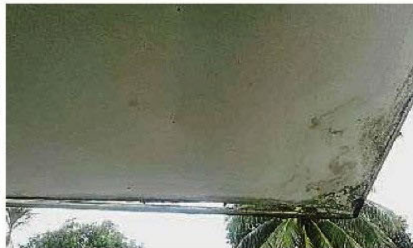
小甘密华小石膏板阳棚损毁，带来安全隐患。
