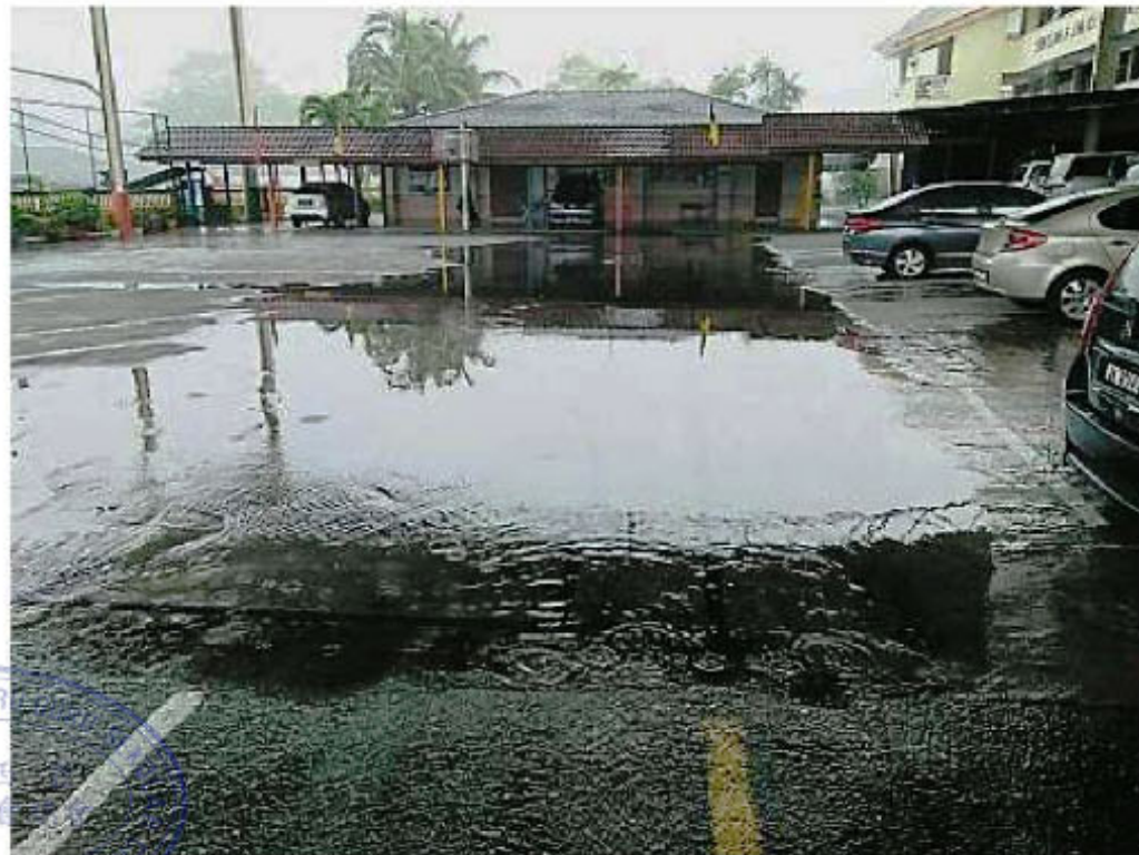
▲黄添佑强调，严重损毁的雨盖，要进行工程维修才能解决问题，但资金实在有限。
