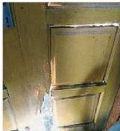
学校课室的木门严重破损及遭白蚁蛀蚀，呈现大洞。
